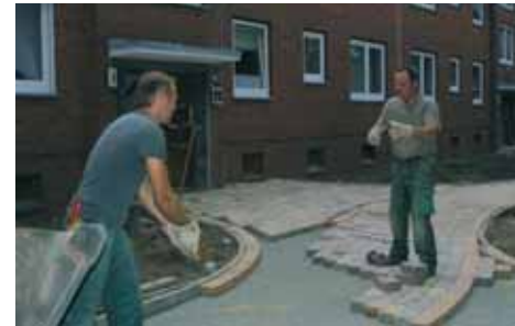
In der Meraner Straße 9 bis 11: Die Mitarbeiter des Unternehmens Grewe Grünflächenservice werfen sich die Betonsteine zu, gerade wurden die Zuwegungen neu gepflastert.
