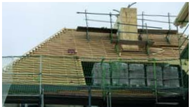
Noch wird die Loggia ausgebaut, sie soll später mal das Prunkstück des Objekts werden. Hinter dem Gerüst ist der neue Vorstellbalkon zu sehen.
