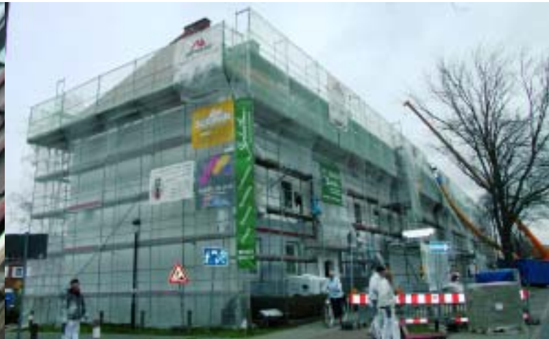
So sieht es momentan in der Hemmstraße 260-278/Ecke Mittelwiese 1a aus: Bis zum Herbst sind die Arbeiten für den dritten und vierten Bauabschnitt beendet.
