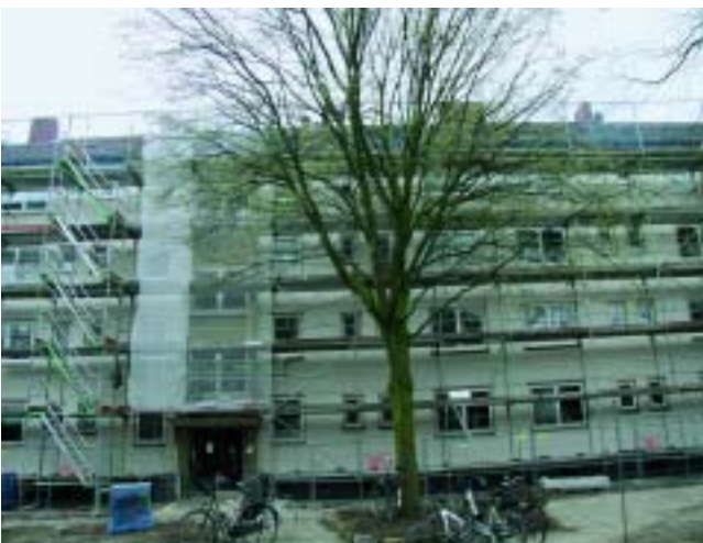
Kasseler Straße 74 – 80: Das Gerüst steht schon, Dach und Fenster sowie die Außenfassade werden erneuert.
