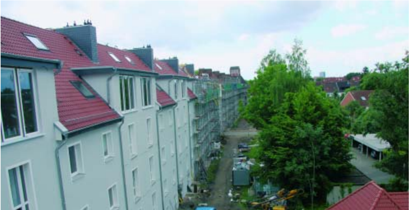
Ein Blick vom Balkon Utbremer Ring 120: Das Eckhaus in der Hemmstraße (links) ist fertig, hinten bis zur Mittelwiese 1a laufen die weiteren Sanierungen.
