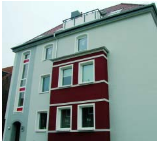
Mittelwiese 1a: Hier werden gerade noch die letzten Arbeiten für die Loggia umgesetzt.
