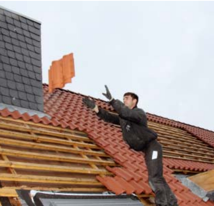
Akrobatik auf dem Dach: Didi Thurau fängt die Dachpfannen eines Kollegen auf. Im I. und II. Bauabschnitt werden ca. 30.000 Pfannen verlegt.
