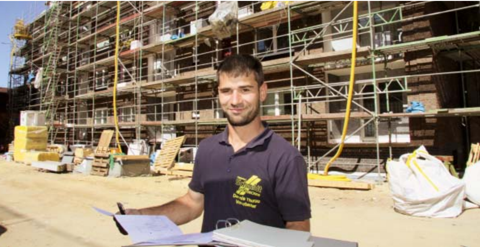
Didi Thureau steht vor dem Block in der Kasseler Straße 39-41: Vor dem Gebäude liegen die Materialien für die energetische Sanierung und den Staffelgeschoßausbau.
