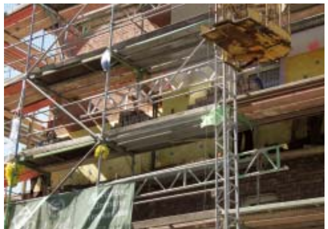
Hier entsteht eine neue Klinkerfassade: Dies ist eine wichtige Maßnahme zur allseitigen Wärmedämmung.
