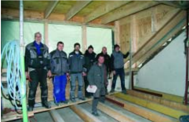
Ewald Heinen (hinten r.) aus der Technischen Objektverwaltung verschafft sich einen Überblick über den Bautenstand.
