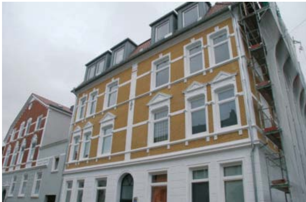
So präsentiert sich die Außenfassade in der Winterstraße 45. Die Arbeiten befinden sich in den letzten Zügen.
