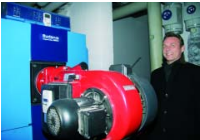
Der Energie-Experte Frank Thiele steht am Öl-Brennwertkessel. Der leistungsgeregelte Brenner vom Typ Weishaupt WM-L10 sorgt für schadstoffarme Verbrennung.
