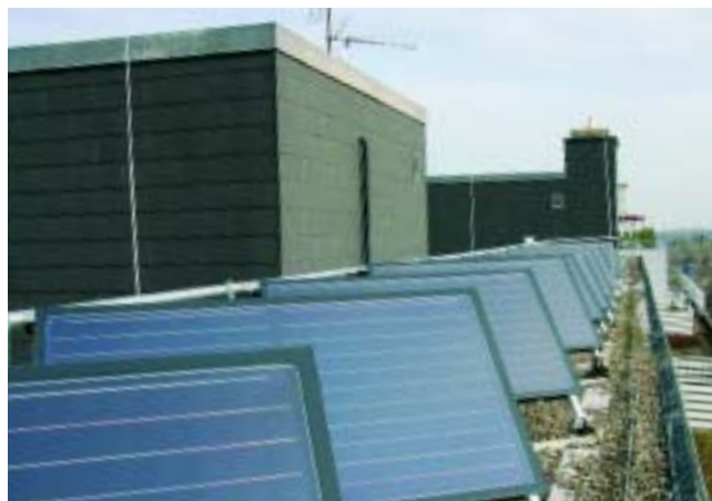
So sieht die neue Solaranlage aus: Die Hochleistungs-Flachkollektoren sind zwischen Glas und Absorber mit Edelgas gefüllt. Das Gehäuse besteht aus einem leichten, hochfesten Fiberglas-Rahmenprofil.
