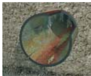
Ein schadhaftes Rohr im Erdreich..
