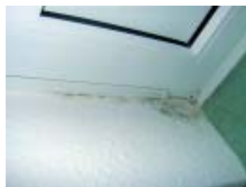
Ein Schandfleck in der Wohnung: Richtiges Heizen und Lüften verhindern allerdings derartige Schimmelpilze.
