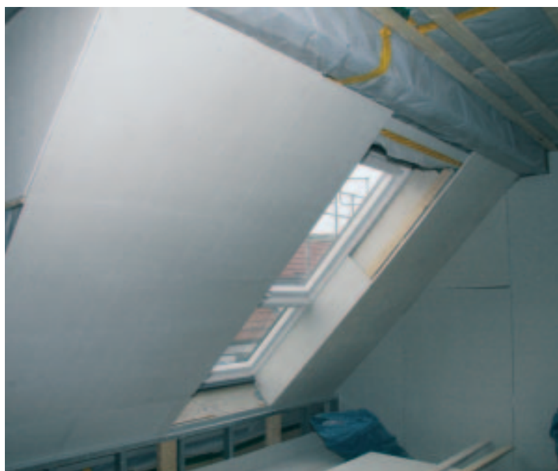
Borgfelder Straße 4: In dieser Dachgeschosswohnung sind die Schrägen bereits mit Platten verschalt.
