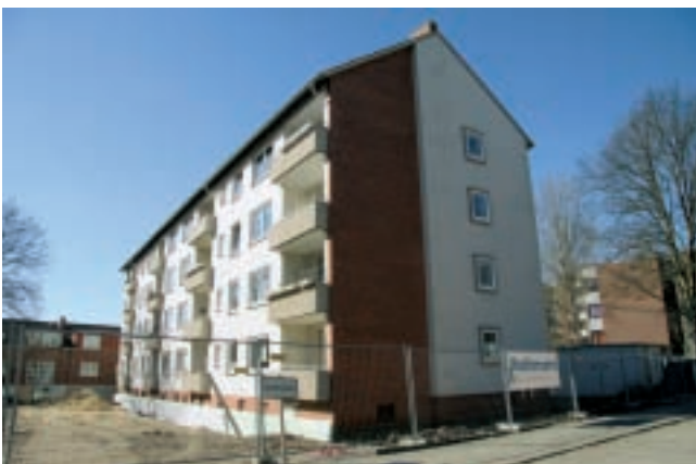
Der Block Kasseler Straße 47 – 49: Hier haben gerade die Arbeiten für den letzten Modernisierungsabschnitt begonnen.
