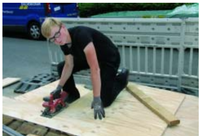
Dachdecker Azubi Florian Hendriks schneidet gerade sogenannte „Douglasie“-Platten für die Sanierung des Dachbodens zu.
