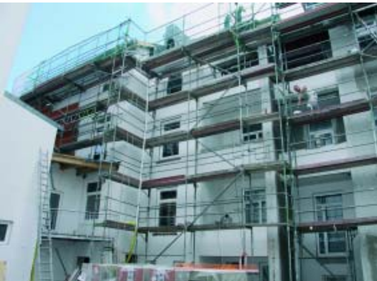
Der Innenhof der Thielenstraße 14 – 44 wird saniert: Gerade werden Wärmedämmplatten angebracht und die Fassade gestrichen.
