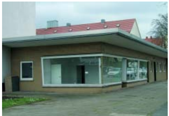
Der Pavillon Dresdener Straße 8 wurde zwischenzeitlich von Künstlern genutzt, wird jedoch abgerissen.
